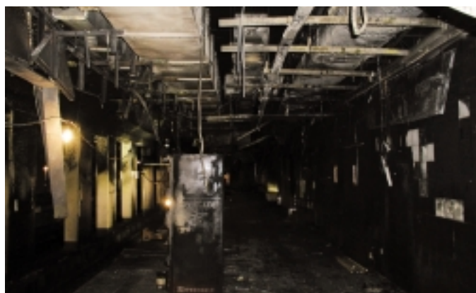
図2 地下3階 ホームの激しい燃毀状況
