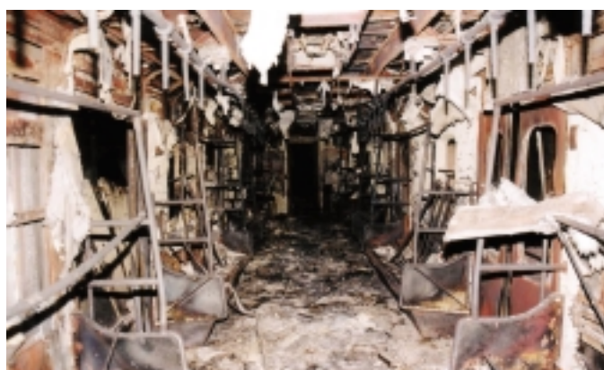
図4 火災車両の内部(2)
