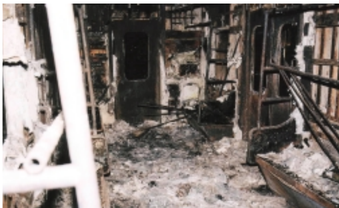
図3 火災車両の内部(1)
